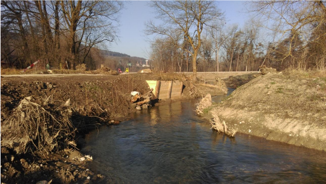
Foto der fertiggestellten Eisvogelwand. Blick in Fließrichtung abwärts (Foto Kästli Bau AG)
